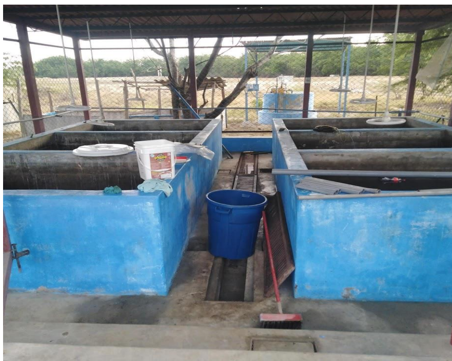
Figura 3. Acondicionamiento de los tanques de concreto del Taller de Investigación experimental en recursos acuáticos I (Imagen propio autor).
