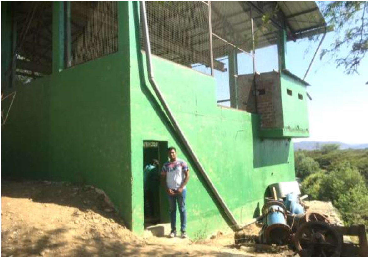
Foto 13: Estación de Bombeo de la Comisión de Usuarios Becerra – Belén
